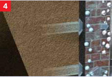
Van buiten indringend vocht Vocht kan naar binnen dringen door het ontbreken van of een defecte buitenafdichting in het metselwerk en/of via de vloer
